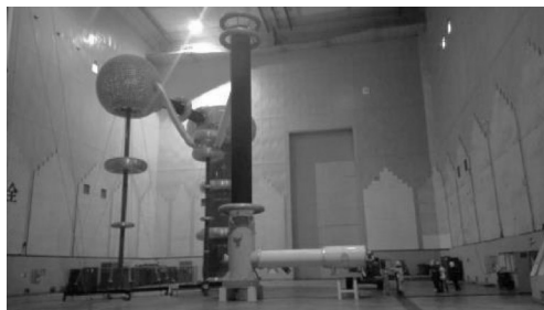
图1 1 100 kV GIS真型试验平台
